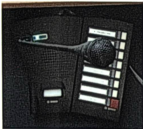
Abb. 19: Lautsprecher der Evakuationsanlage am Empfang.
