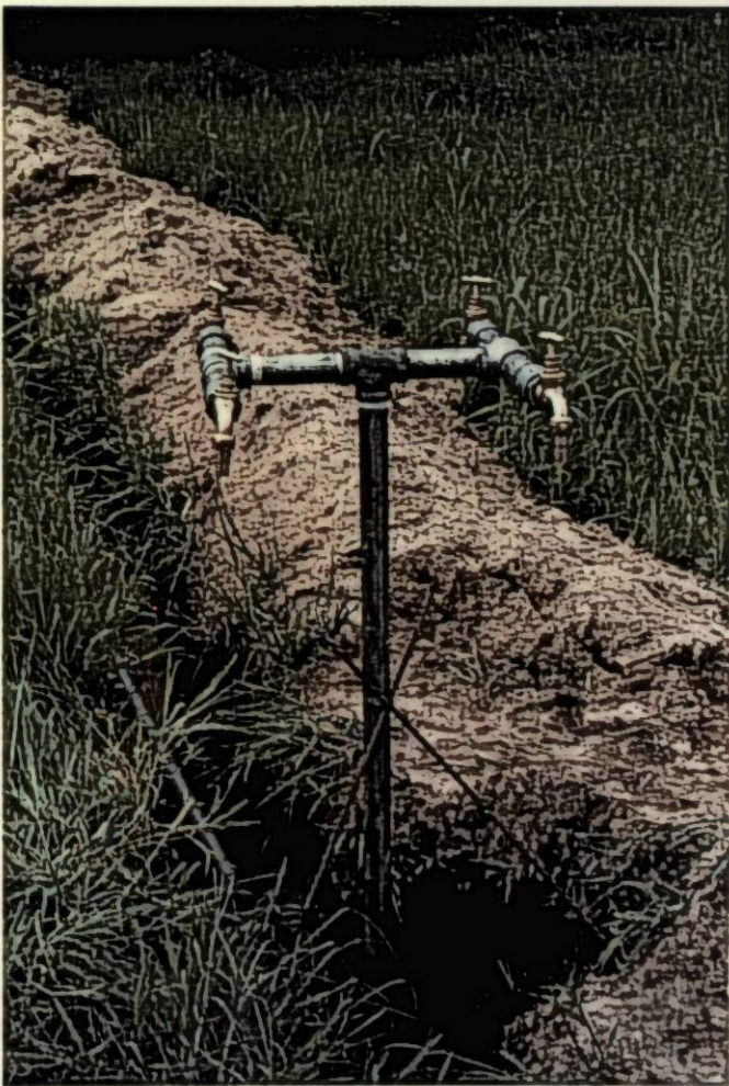
Unterster Verteiler beim neuen Gartenteil.
