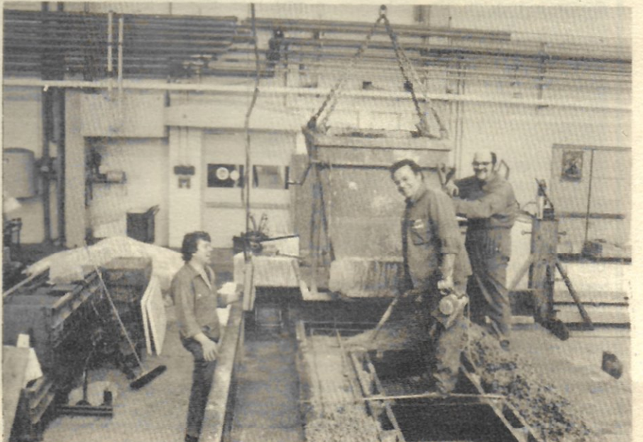
Die «Betonierer vom Dienst» noch an ihrer bisherigen Arbeitsstätte im Technischen Zentrum in Schaan (v.l.n.r.): P. Ortner, Th. Hilti und der Leiter des Teams, L. Thomann.
